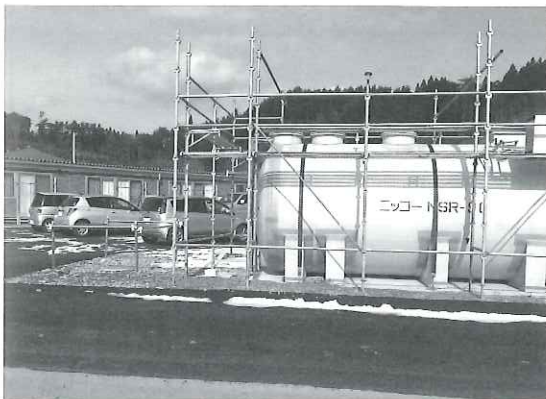
東日本大震災の後、仮設住宅に設置された浄化槽（震災から1年後に南三陸町志津川中学校で）
